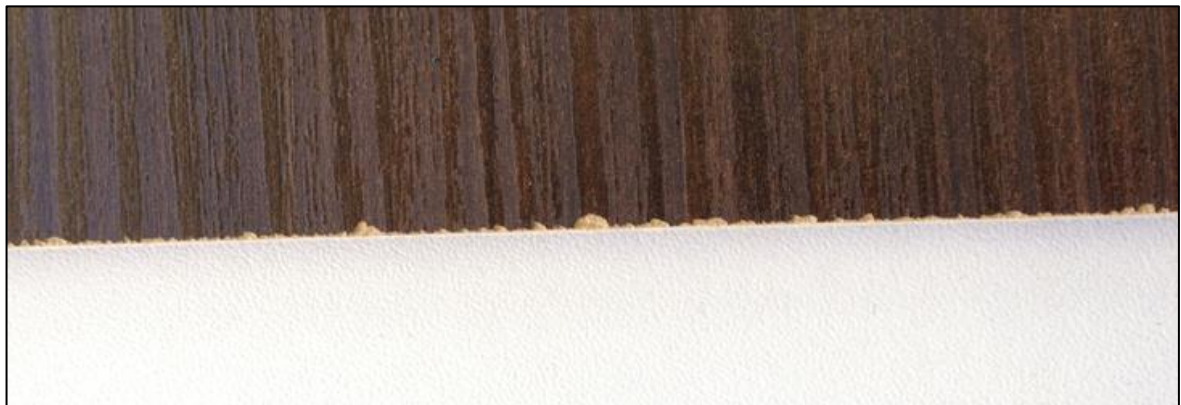
Imagem: Deslocamento do Revestimento.
